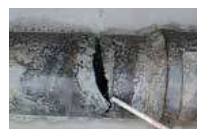
ネジ部からの漏水
